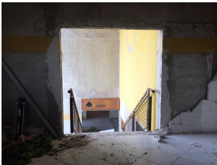
Figura 2 | Particolare dell'interno del quarto piano con i lavori di demolizione iniziati. Le scale che, da progetto originario collegavano diversi livelli nel piano libero, non erano più fruibili perché si trovavano all'interno delle occupazioni. Foto dell'autore, scattata l'11 febbraio 2019.
