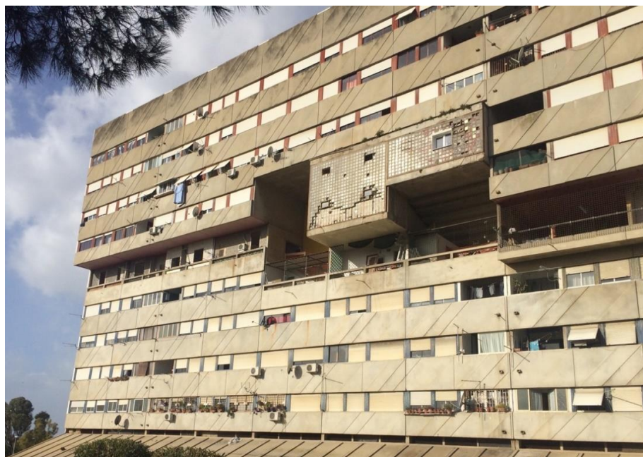
Figura 1 | Particolare della facciata di Corviale. In blu le case in linea e in rosso quelle a ballatoio, suddivise dal piano libero. Sulla sinistra della foto si notano i lavori di demolizione della fase 0 dell'intervento del quarto piano. Foto dell'autore, scattata il 5 febbraio 2019.
